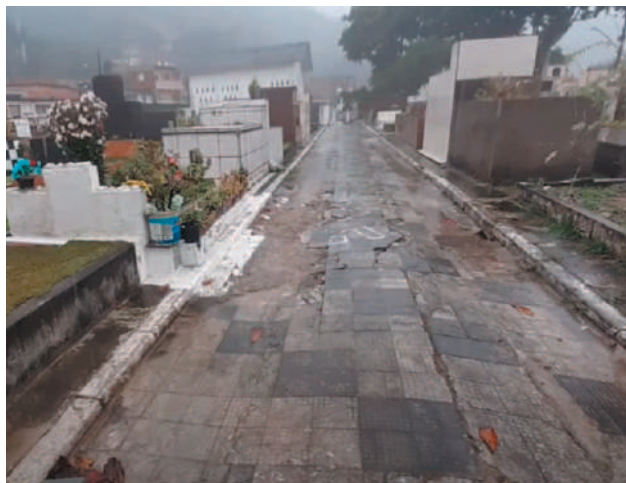
Muito além de limpeza e pintura, cemitérios apresentam falta de drenagem, equipes de funcionários reduzidas e sérios problemas de acessibilidade nas vias internas
