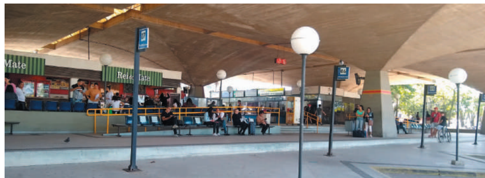
O prédio está decadente e com o mau cheiro dos banheiros
